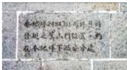
圖4-2經多次修繕造成原角度移位
